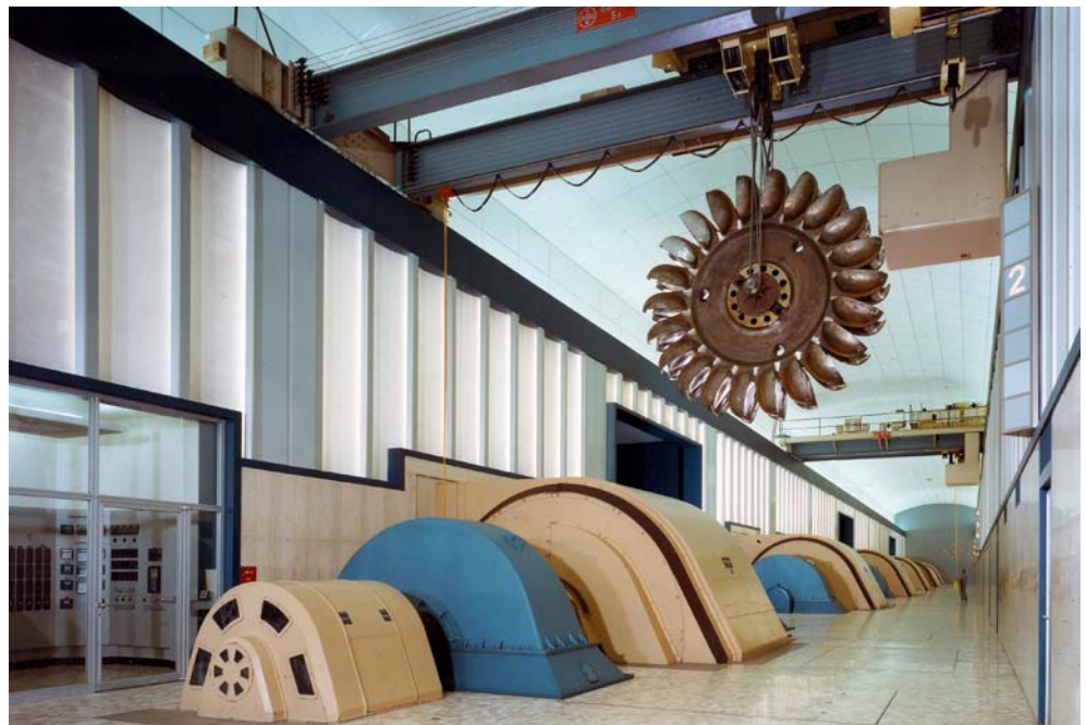
Alstom dispose d'un large savoir-faire dans la modernisation des centrales électriques existantes.
